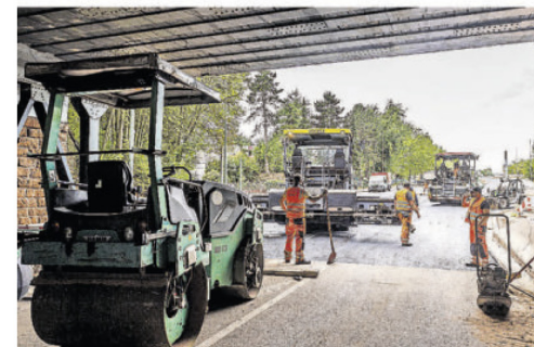
Beim Rückbau des Kreisverkehrs am Kaufland-Einkaufsmarkt in Merzig wirkte die Firma dittgen ebenfalls mit.
